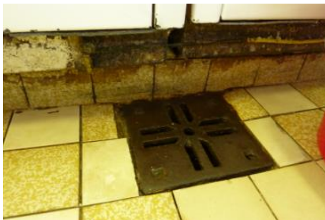
Havarijní stav zdravotních instalací
